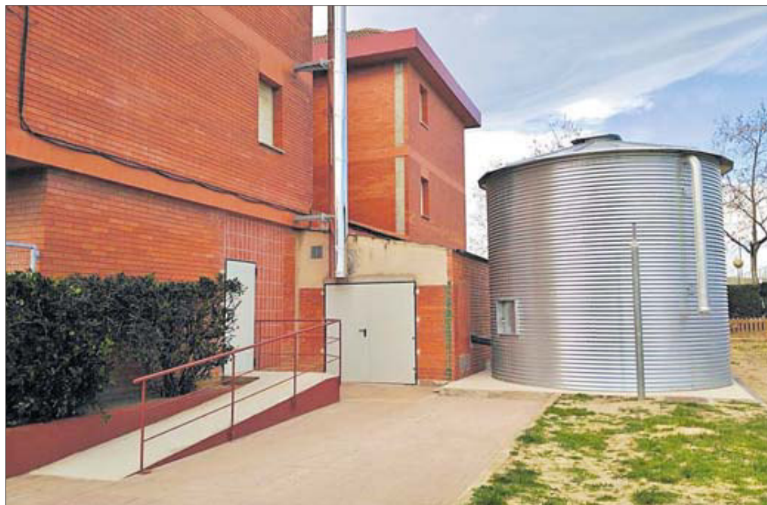
La caldera de biomassa de l'escola Anicet de Pagès es va instal·lar el 2017. AJUNTAMENT DE FIGUERES
