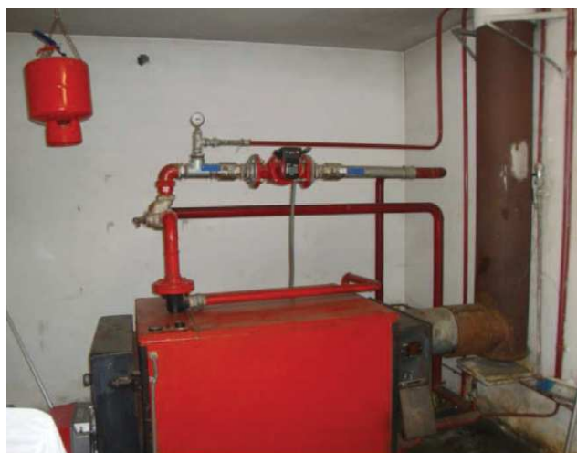
Sales de Calderes Aulari de Primària (Edifici Principal)
